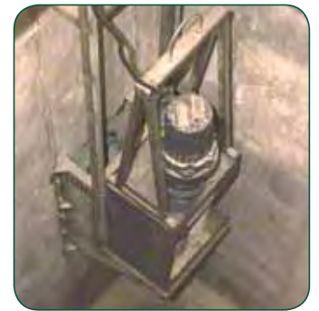
CMD avec rails de guidage dans une station de pompage.
