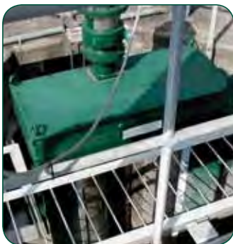
Channel Monster CDD en entrée de station.
