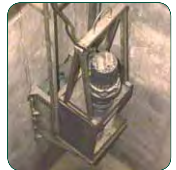
Channel Monster z prowadnicami zainstalowany w pompowni.
