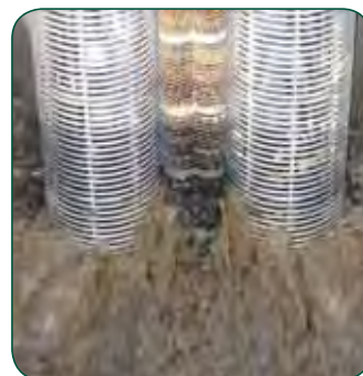
Wypływ ścieków z urządzenia model CDD-XDM2,5.
