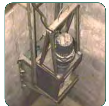
Channel Monster installerad i pumpstation med styrkonsol.
