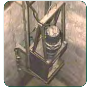
Kılavuz řasi ile pompa istasyonuna monte edilmiř Channel Monster.
