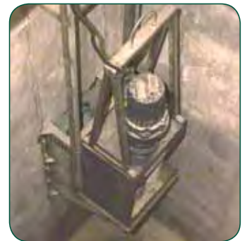
Channel Monster asennettuna pumppuasemalle asennuskehikkoon.
