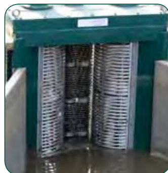
Malli CDD6020-XMD2 asennettuna tulopumppaamoon.
